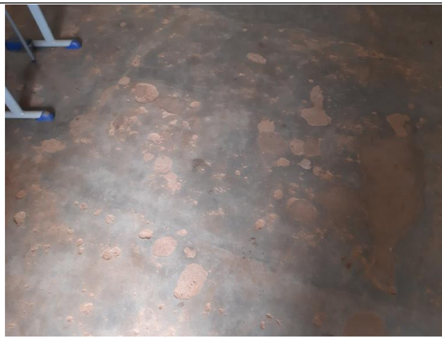
Piso em mal estado – Executar piso em granitina
