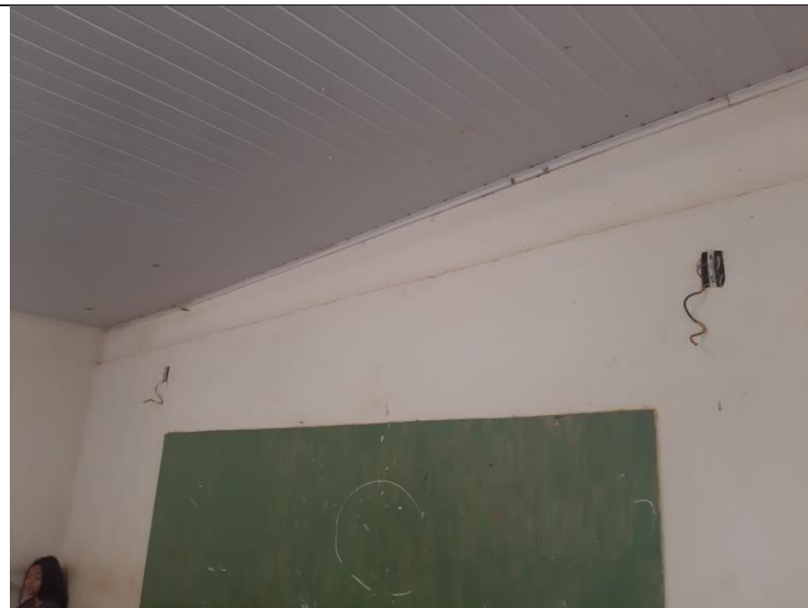
Fiação exposta – Trocar pontos elétricos
