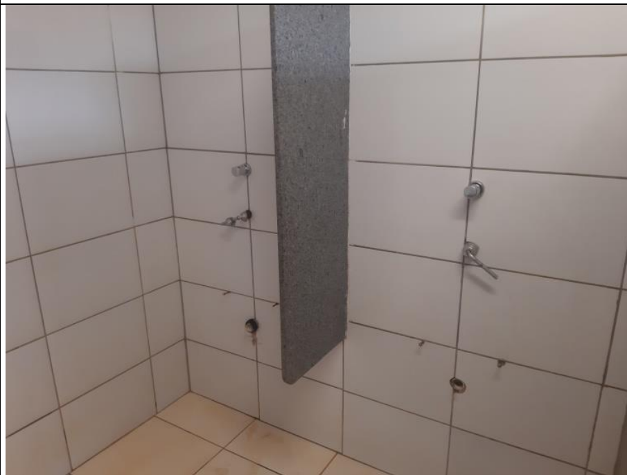
Sanitários Masculino - Instalar mictórios
